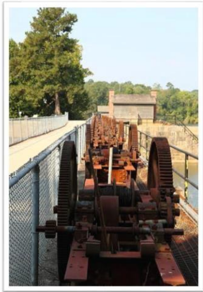
Figura 27. Mecanismo de las compuertas de cabecera
